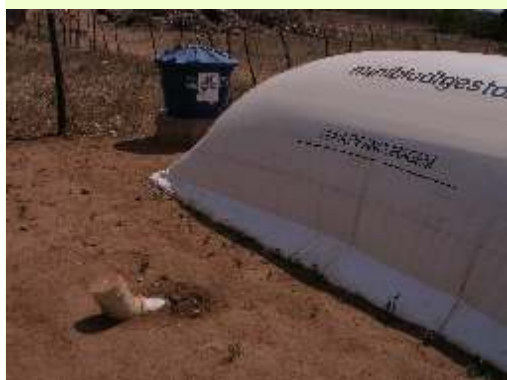
Biodigestor de lona vinílica instalado pelo Eco-Engenho em Alagoas
